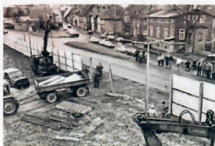
Am 22. Januar 1990 startet in Dassow der Abbau der Grenzanlagen. Anwohner verfolgen den Abriss der Betonmauer.
